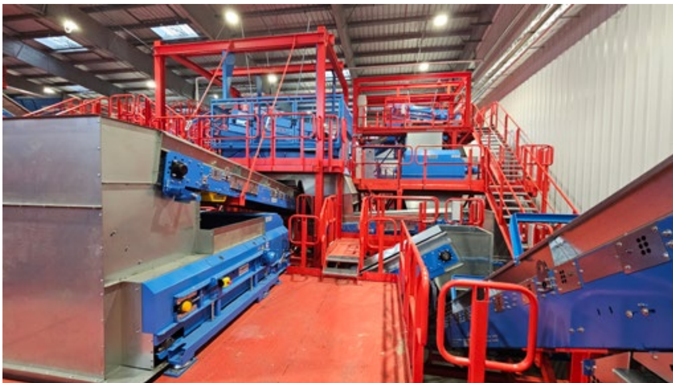
FOT. 1 Sortownia odpadów, separatory Magnetix odzyskują metale żelazne i nieżelazne ze zmieszanych odpadów komunalnych oraz odpadów pochodzących z selektywnej zbiórki.
