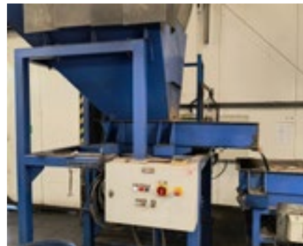
FOT. 3. Podajnik wibracyjny z szafą sterującą w linii do recyklingu baterii [ZŹRÓDŁO: INWET SA]
