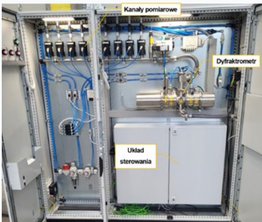
FOT. 1. System 9-kanalowego pomiaru składu ziarnowego online
