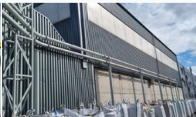
FOT. 3 Przenośnik TDC marki HAPMAN (na zewnątrz budynku)
