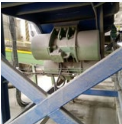
Zespół kruszarki z podajnikiem wibracyjnym napędzanym silnikami wibracyjnymi marki Friedrich typu F 600-6-3.4 – instalacja do recyklingu szkła
