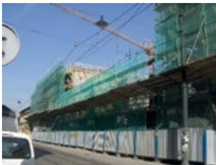
FOT. 1.2 Rusztowanie ochronne z daszkiem ochronnym
