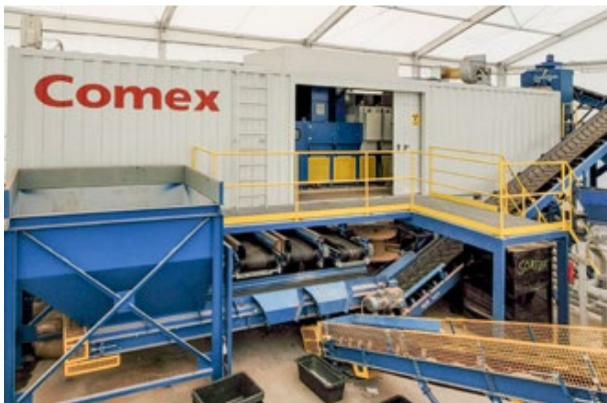
FOT. 8 Układ pilotażowy w zabudowie kontenerowej (separator optyczno-rentgenowski) do koncentracji rud i polepszania kaloryczności węgla [ŹRÓDŁO: COMEX POLSKA]
