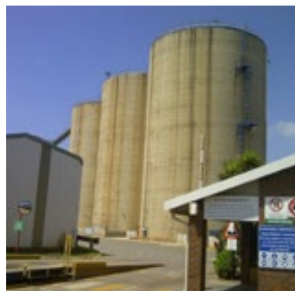
FOT. 1 Silosy Bostwana Ash do przechowywania sody
