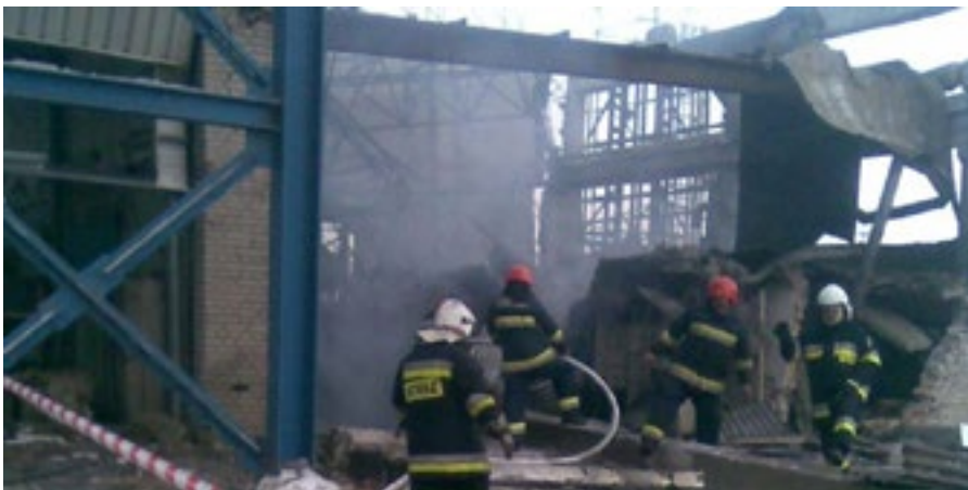
FOT. 2, 3 Wybuch w Elektrowni Dolna Odra
