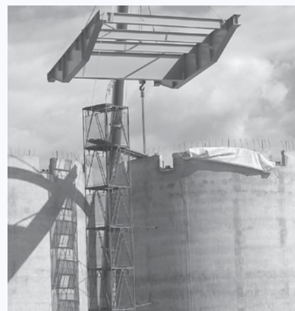
FOT. 6 Montaż stalowej konstrukcji pod galerią stalową żelbetowy strop silosu [źródło: Uniserv S.A.]
