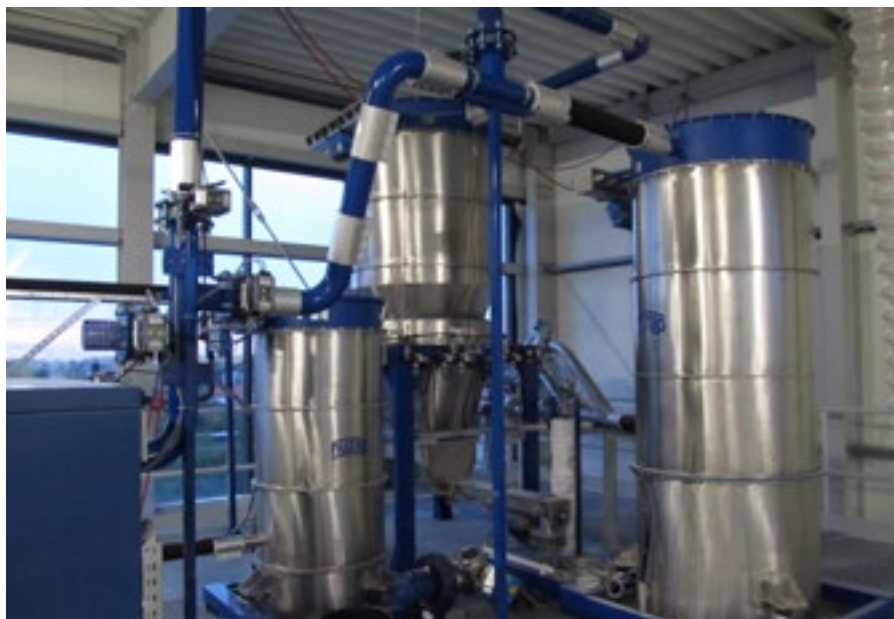
FOT. 5 Przykład instalacji firmy Huzap
