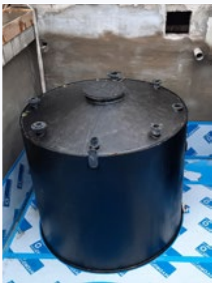
FOT.2 Montaż zbiorników z tworzyw sztucznych laminowanych na nieczystości ciekłe laboratoryjne (tzw. instalacja zielona) oraz na ścieki niskoaktywne (instalacja czerwona) zabudowane w komorze podziemnej.
