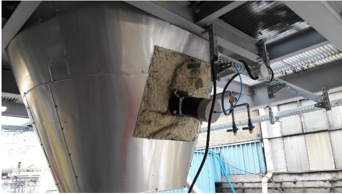
FOT. 7 Odbijak FKL HT na gorącym ciągu technologicznym
