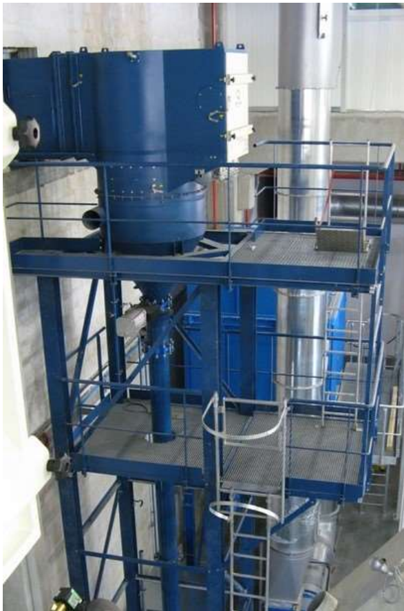
FOT. 2 Instalacja centralnego odkurzania wybuchowych pyłów gumy i sadzy – w wykonaniu zgodnym z ATEX. Oprócz instalacji odpylania przy procesie przygotowywania komponentów do produkcji opon można wykorzystać także instalacje centralnego odkurzania pyłów wybuchowych. W prowadzonym projekcie pył wybuchowy kategorii St 1 i St 2 pochodził z ponad 100 różnych składników, dla których zainstalowano aż sześć instalacji centralnego odkurzania zabezpieczonych przed skutkami wybuchu zgodnie z wymaganiami dyrektywy ATEX
