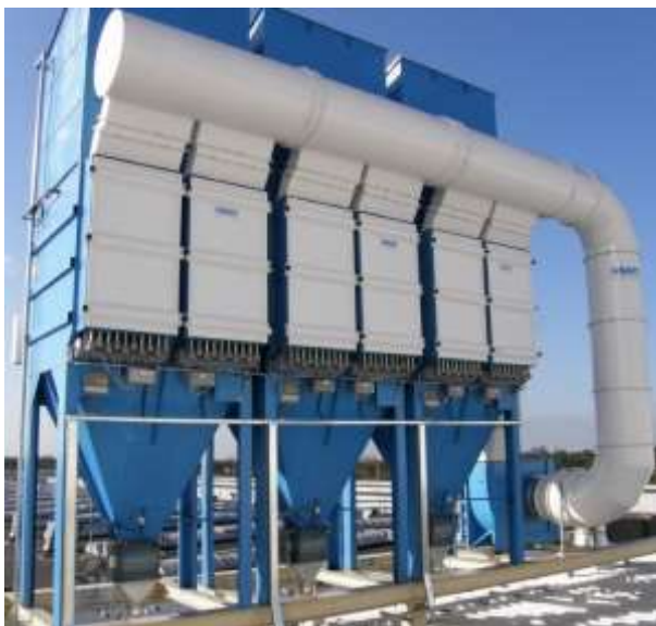
FOT. 1 Instalacja filtracji pyłów chemicznych z maszyn służących do mieszania związków chemicznych, stanowiących surowce do produkcji opon, o wydajności 30 000 m 3 /h
