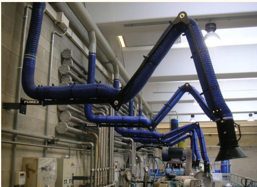
FOT. 4 Instalacja wentylacji wielostanowiskowej
