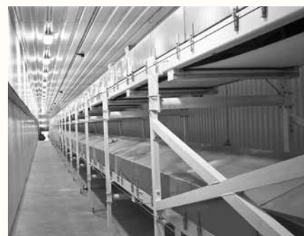
FOT. 3 Urządzenia transportowe w silosie na cukier: a) obudowany przenośnik kubelkowy we wnętrzu wieży transportowej, b) obudowany przenośnik ślimakowy w galerii transportowej [Chemadex S.A.]
