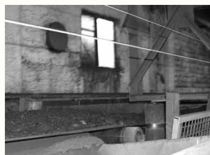
FOT. 4 Przenośnik taśmowy transportujący węgiel nad bunkrem w elektrociepłowni
