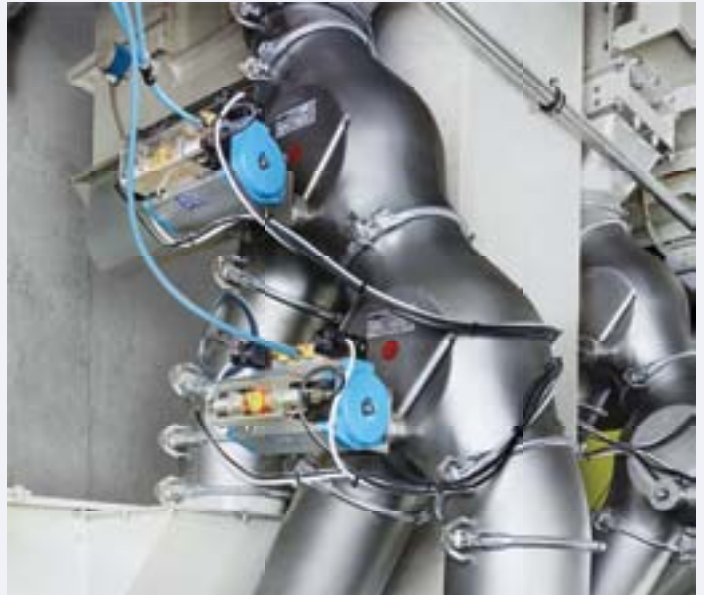
FOT. 9 System rurowy Jacob – instalacja w strefie ATEX
