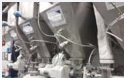
FOT. 3 Wibratory liniowe FP EX zainstalowane na silosach
