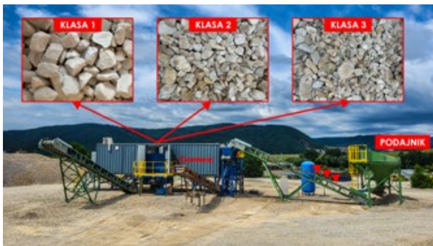
FOT. 2 Przykład zastosowania instalacji OCXR-1000-3F
