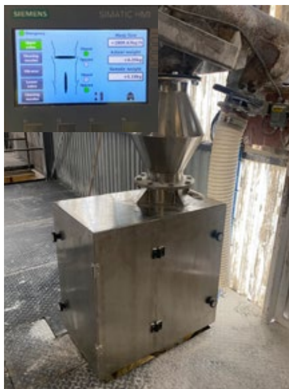
FOT. 1 System MFX zastosowany do drobnego materiału
