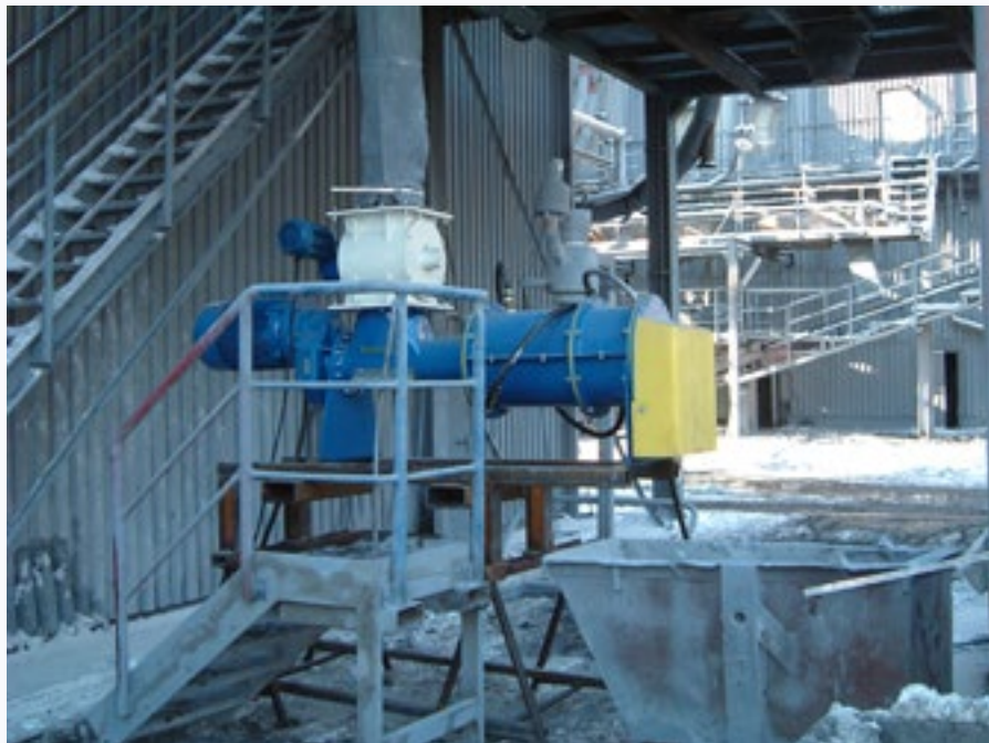
FOT. 1 Dustfix – nawilżanie pyłu w stalowni
