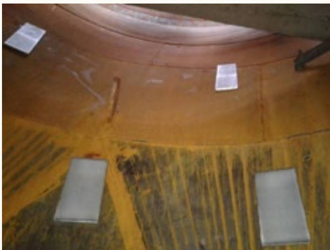
Listwy aeracyjne ze spieków porowatych (ze stali nierdzewnej) zamontowane na ścianach silosu
