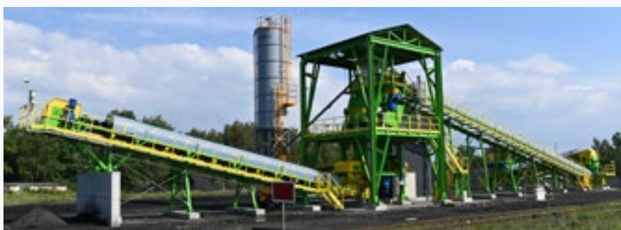
FOT. 2, 3, 4 Linie technologiczne homogenizacji i granulacji zamontowane przez firmę IdeaPro w zakładach przetwarzania mialów węglowych i pyłów węglowych
