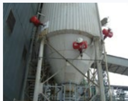
FOT. 4 Armatki powietrzne na silosie [Źródło: Inwet]
