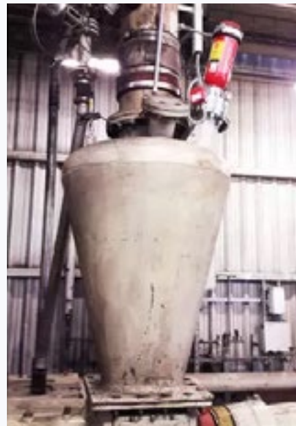
FOT. 4 Zabezpieczony zbiornik buforowy pyłu węglowego
