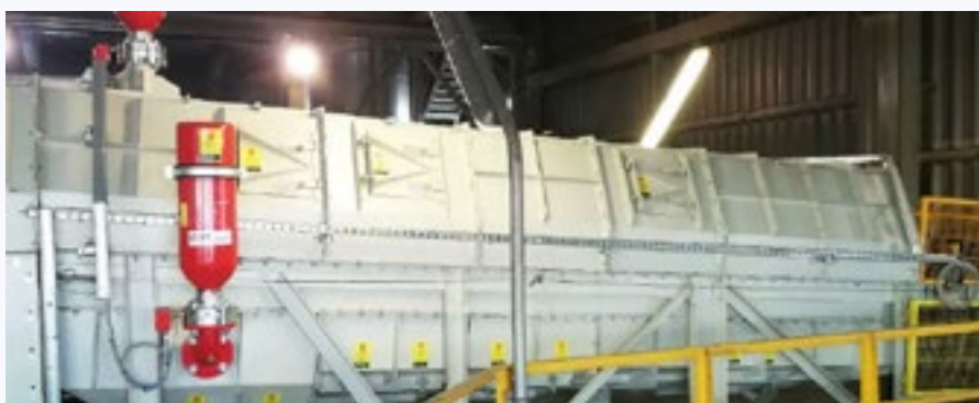
FOT. 5 Zabudowany taśmociąg dostarczający miał węglowy z hali węgla do zbiornika miału węglowego, zabezpieczony za pomocą systemu odprężania wybuchu typu HRD na zasypie do zbiornika.
