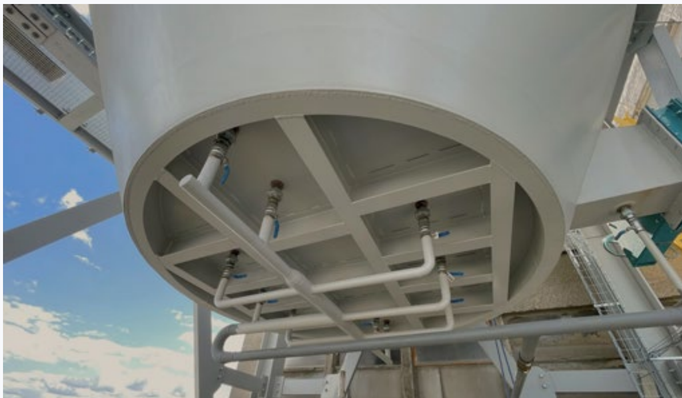
FOT. 1 Płaskie dno aeracyjne silosu na cement o pojemności 100 m 3
