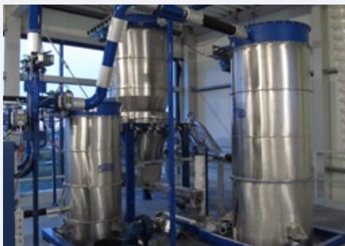
FOT. 2 Przykład instalacji firmy Huzap
